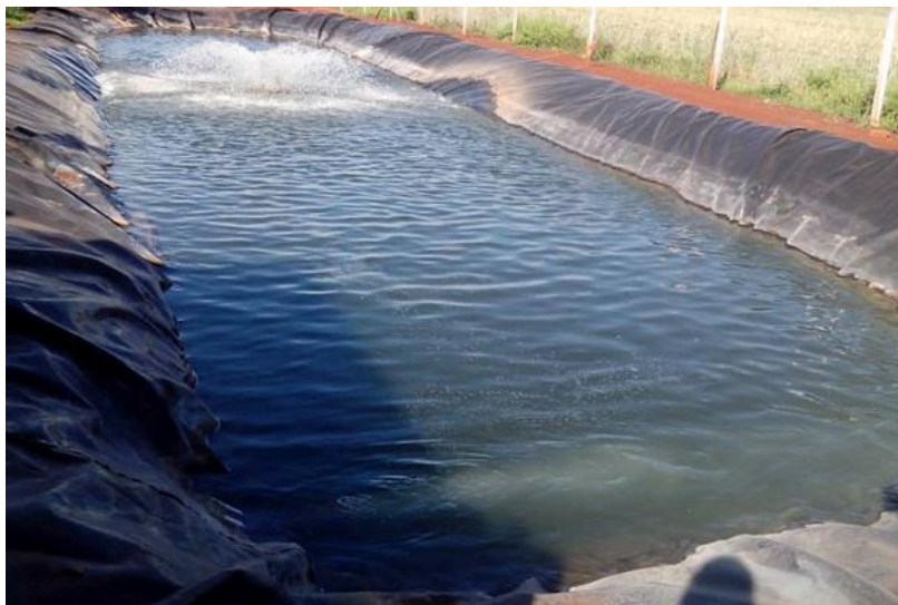
Figura 6 – Lagoa aeradora da lavanderia
