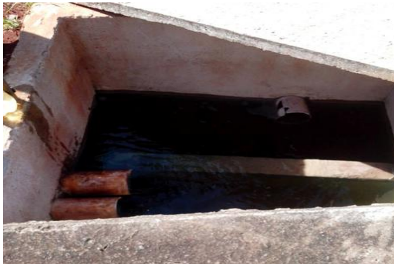
Figura 8 – Caixa de concreto pelo qual a água tratada circula até ser despejada ao rio
