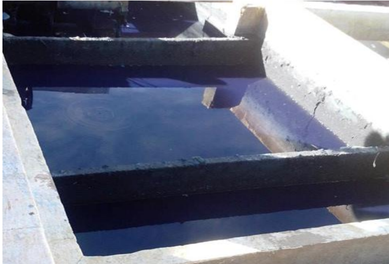
Figura 3 – Caixas de concreto utilizadas no tratamento de efluente
